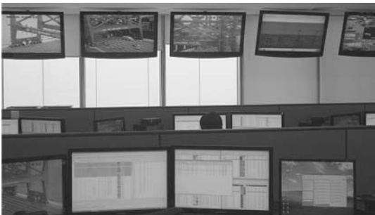
写真12：コントロール室のモニタリング・システム
