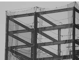
図18. 建設中のビルの鉄骨 実際は四角形であるが見る角度で直角三角形に見える
